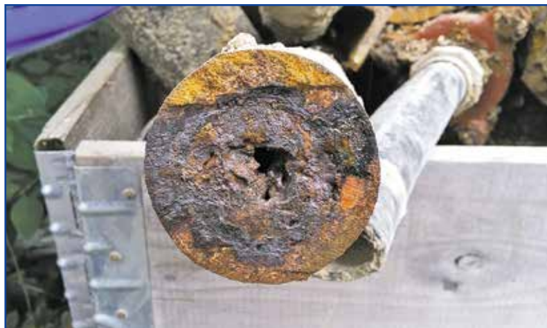
De gamle vandledninger i Tårnby udskiftes løbende. Nogle gange har tidens tand medført, at de er næsten helt tilstoppede.
