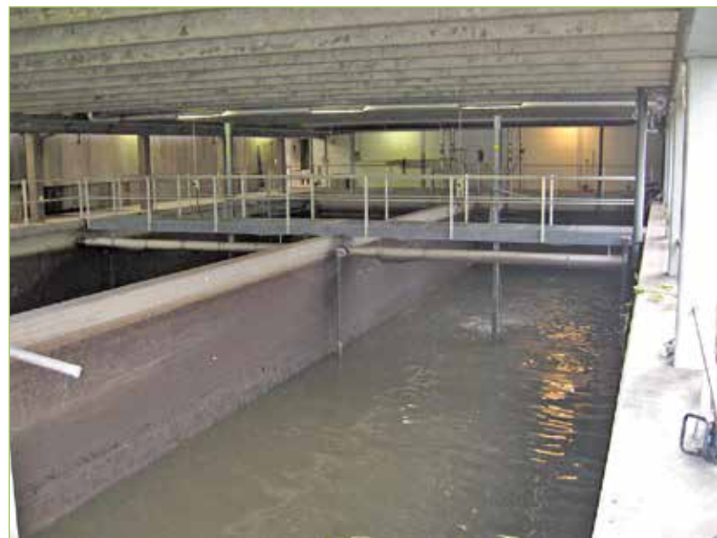
Ikke synderligt interessant foto, men disse bassiner stod tomme efter et tidligere procestrin blev droppet - indtil man (!) fandt på at bruge to af dem til et forsinkelses reservoir. Da Tårnby Bladet besøgte renselanlægget var der brug for kapaciteten omkring 5000 kubikmeter kloakvand.
