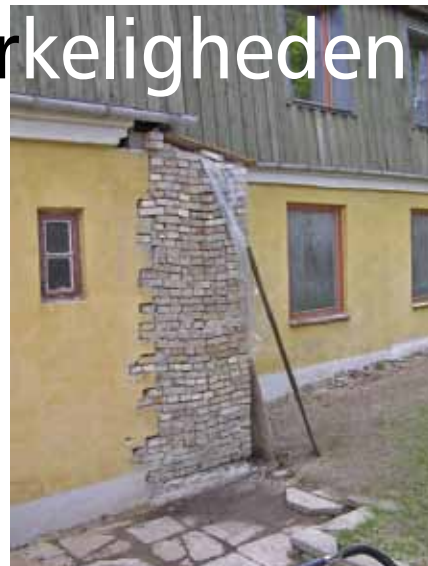
En tilbygning som denne skønnes ikke at kunne gøres lovlig. Det ender nok med en nedrivning. Arkivfoto.
