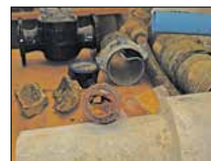
Eksempler på gamle vandrør, der er udskiftet. Flere venter under jorde.
