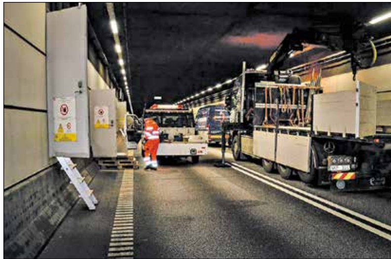
Har du nogensinde tænkt over, hvad der egentlig sker i det lukkede tunnelrør, når der ikke er nogen trafik? Her kan du se, hvordan det så ud under den seneste lukning i maj.
