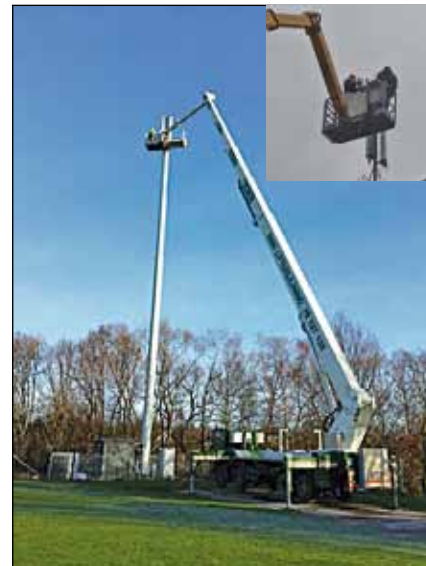
TDC har de sidste par uger været i gang med at udskifte udstyret på selskabets mobilmaster, og det skulle angiveligt være med til at forbedre mobildækningen på Amager og omegn betragteligt.
