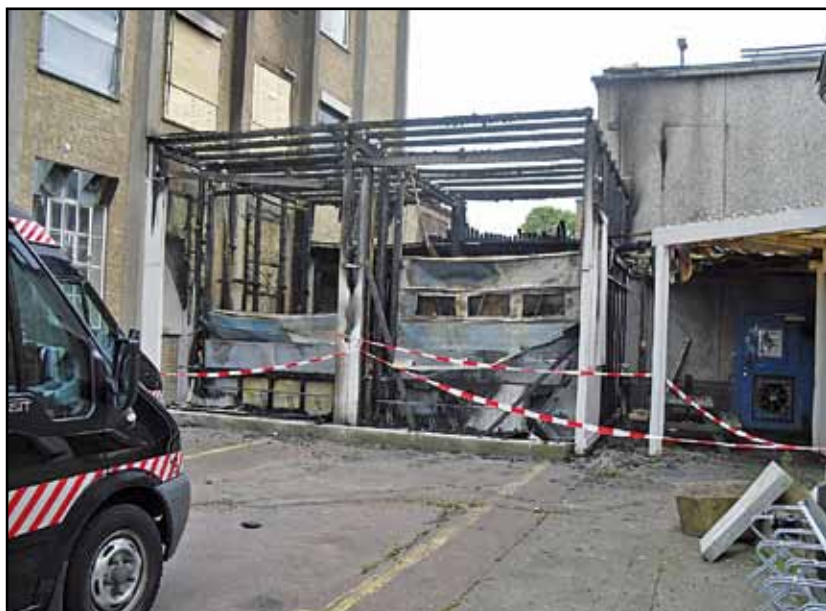
Bygningen mellem Amagerstrandvej 350 og Saltværksvej blev antændt af varmen fra containeren og bliver nu fjernet.
